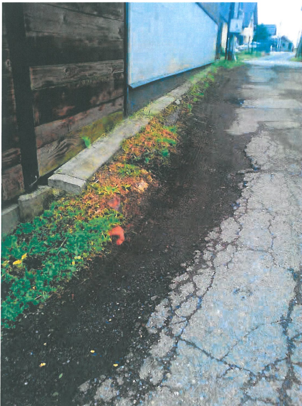
Rysunek 1. ul. Szczytowa, zniszczony asfalt
