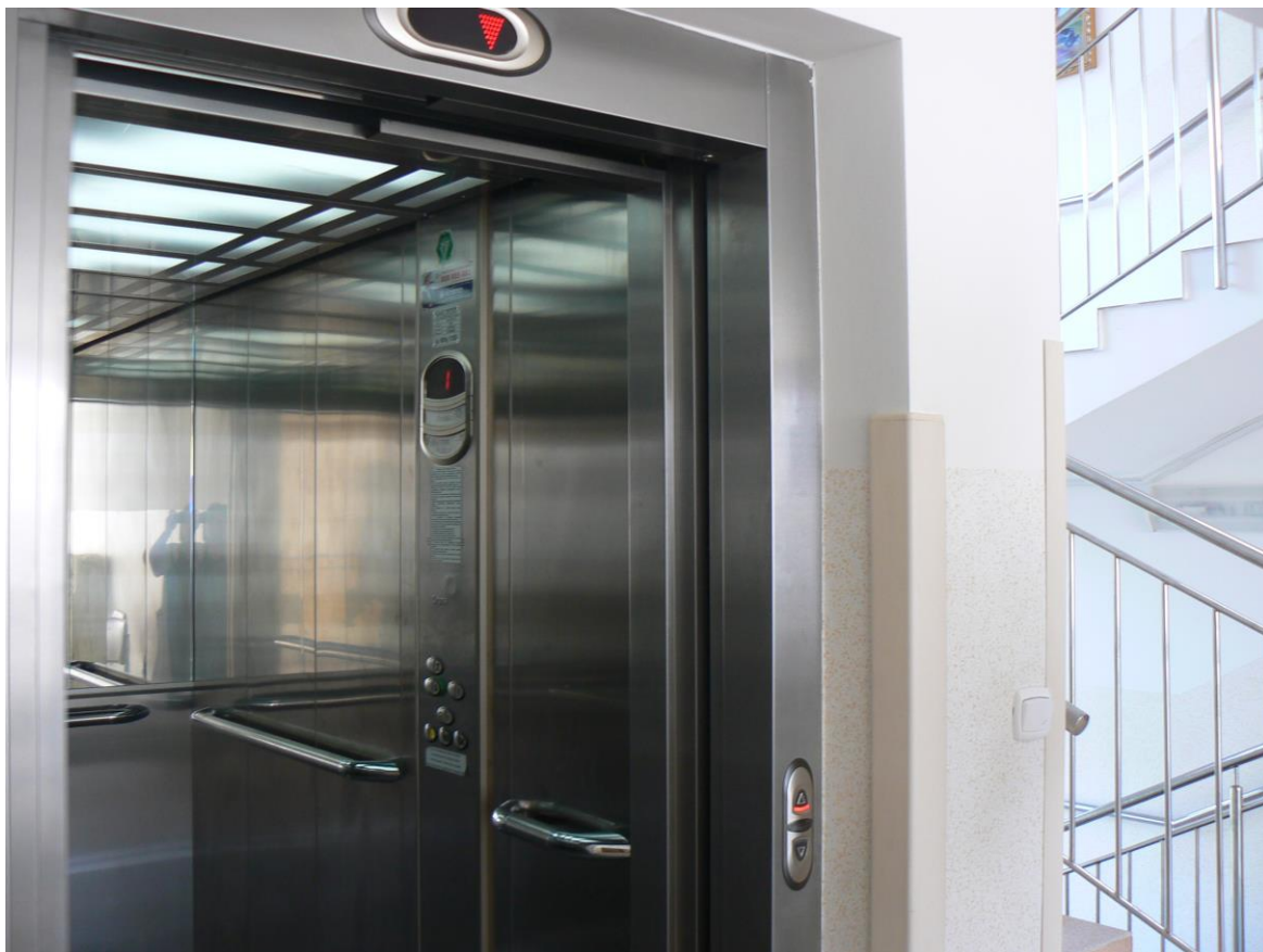
Zdjęcie nr 7. Winda osobowa dostosowana do potrzeb osób niepełnosprawnych DPS przy ul. Powstańców Śląskich 4 (2011 r.).
